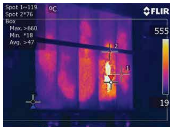
Kuva 5: Termograafinen kuva osoittaa romahduspisteet pystytolppien välissä lasivillakerroksen keskellä.
