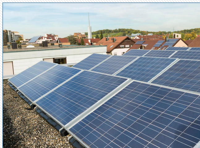
Ilustracja 3: Panele solarne na dachu płaskim (źródło: IVPU)
