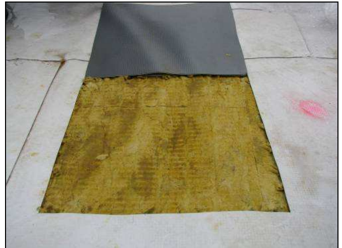
Abbildung 22: Öffnungsstelle 3 mit oberflächlich feuchter, aber insgesamt trockener (0,7 Masse-%) Dämmung
