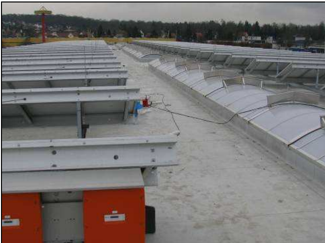
Abbildung 21: Dachfläche mit mittig angeordnetem Lichtband und seitlich aufgereihten Fotovoltaik-Anlagen.
