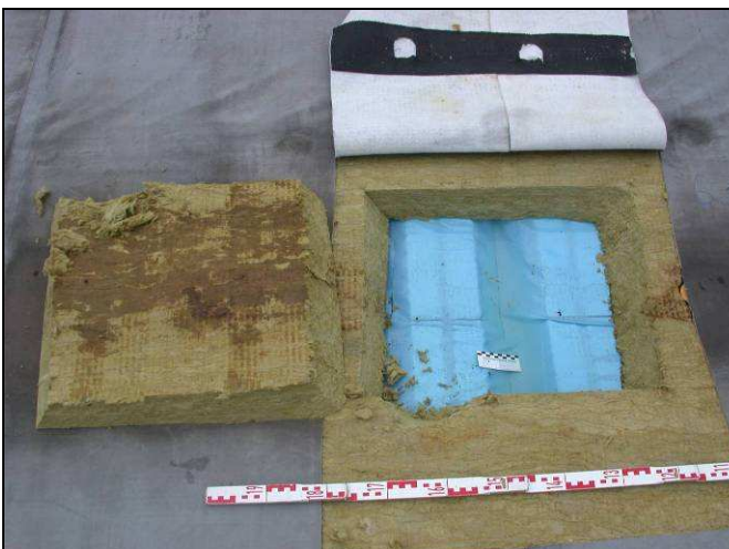
Abbildung 18, 19 und 20: Erheblich durchfeuchteter Dämmstoff über einer Tiefsicke, in der Wasser steht.
