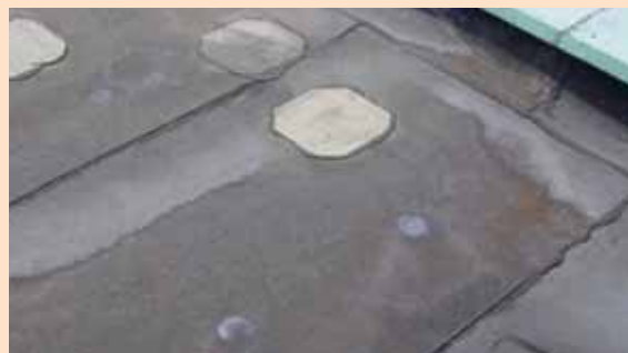
Eksempel på et beskadiget tag
