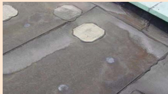
Ejemplo de una cubierta deteriorada
