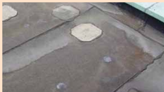
Exemple de toit endommagé
