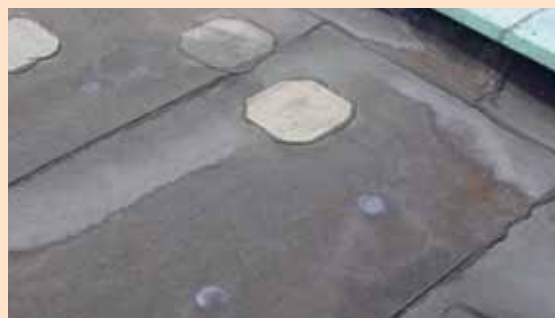
Esempio di tetto danneggiato
