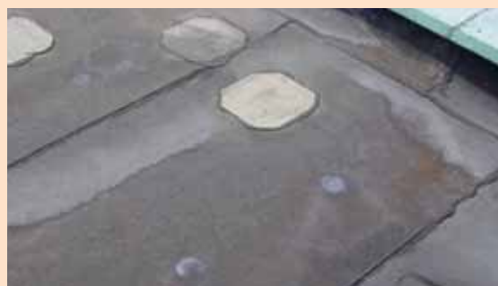
Voorbeeld van een beschadigd dak
