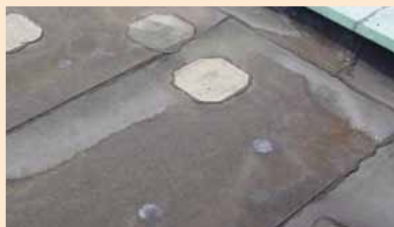
Příklad poškozené střechy
