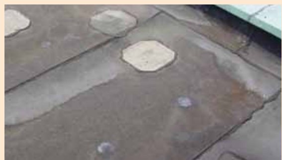
Przykład uszkodzonego dachu
