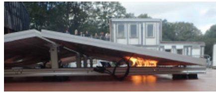
Figura 1: Conjunto fotovoltaico en la cubierta plana tras la ignición del quemador de gas
