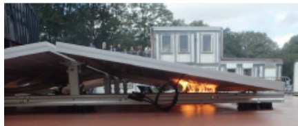
Kuva 1: Loivalla katolla oleva aurinkosähköjärjestelmä kaasupolttimen sytyttämisen jälkeen
