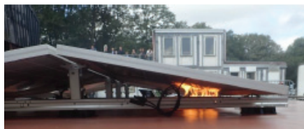
Figur 1: Solcellsanläggning på det låglutande taket efter tändning av gasbrännaren
